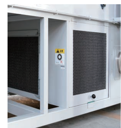
吸气口安装有过滤网。
